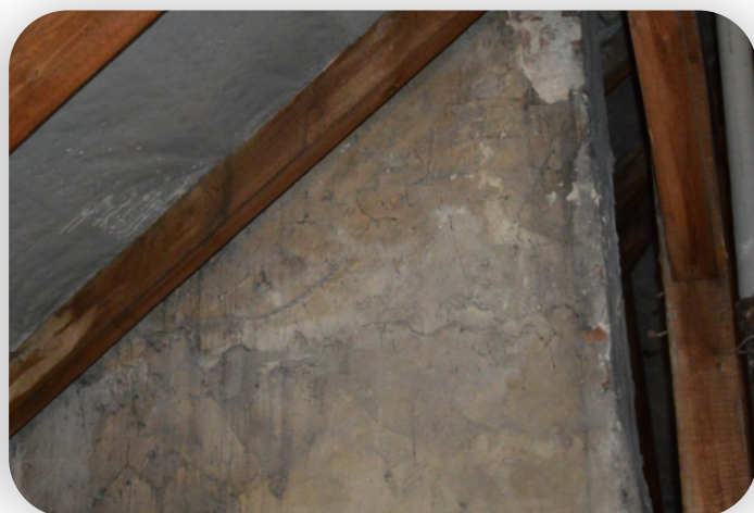
il. 28. Zarysowania i ubytki tynku na kominie (w przestrzeni poddasza nieogrzewanego).
