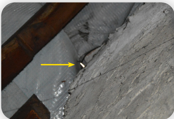
il. 27. Drobna nieszczelność pokrycia przy kominie (w obrębie poddasza nieogrzewanego).
